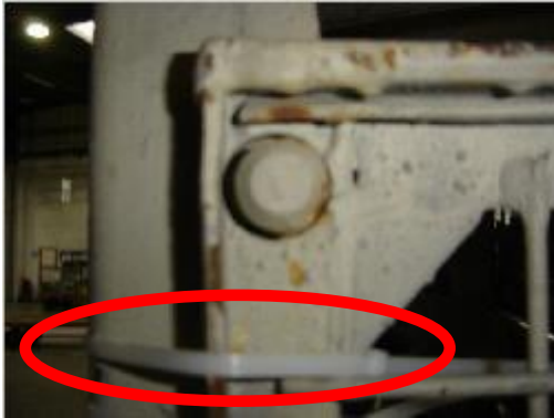
tauschfähig: Kabelbinder dient zur zusätzlichen Sicherung
